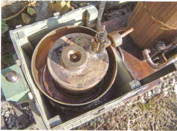
Gastank im Wasserbad.
